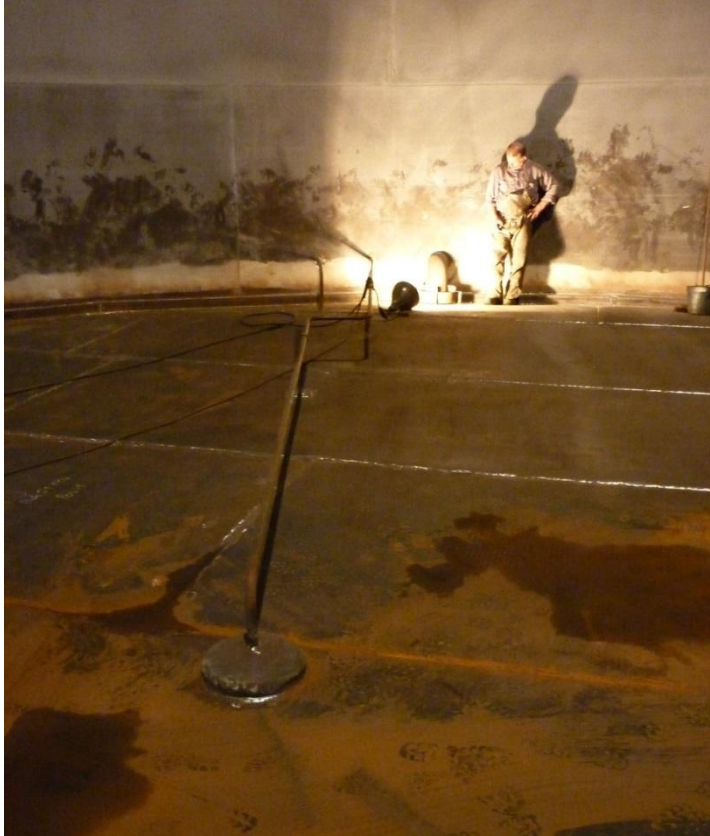
Messleitung zur Tankmitte geführt
